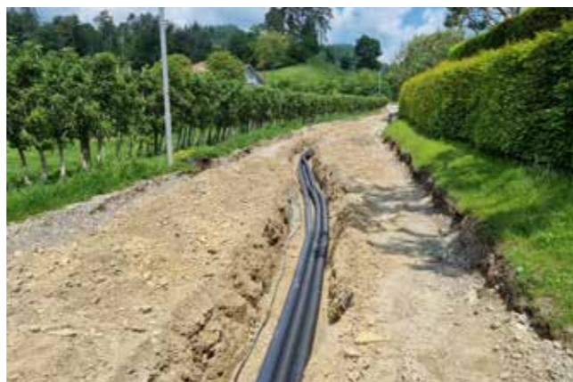
06.2022 | Sanierung der Wasserversorgung & Neuverlegung Glasfaser vom oberen Bereich der Mühlenstraße bis nach Rickenwiesen
